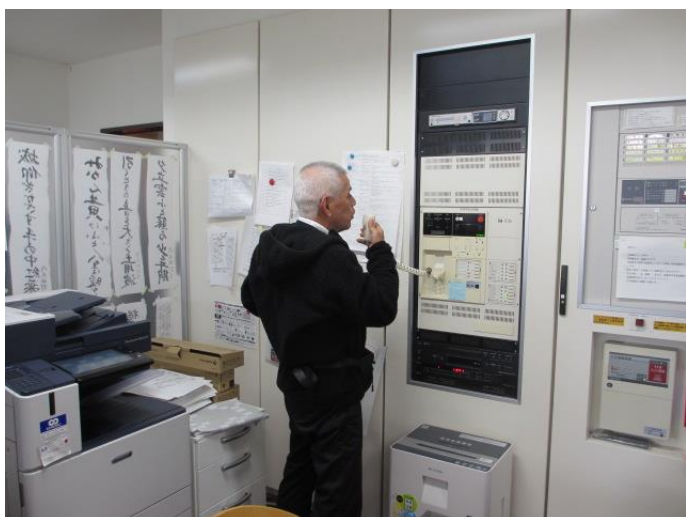
総合防災盤で現場確認・非常放送訓練
