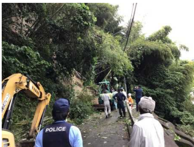
▲7月7日市ノ瀬区土砂崩れ発生
