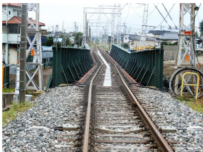
被災時のままの線路
