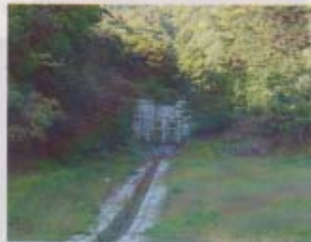
瀬戸内ハイツ上流の砂防えん堤と砂溜工
