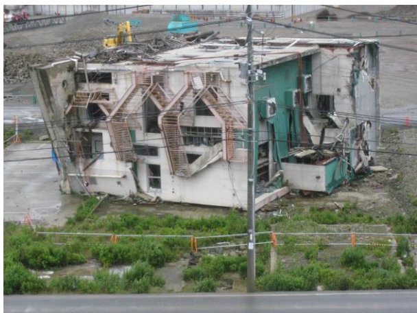
倒壊した江ノ島共済会館
