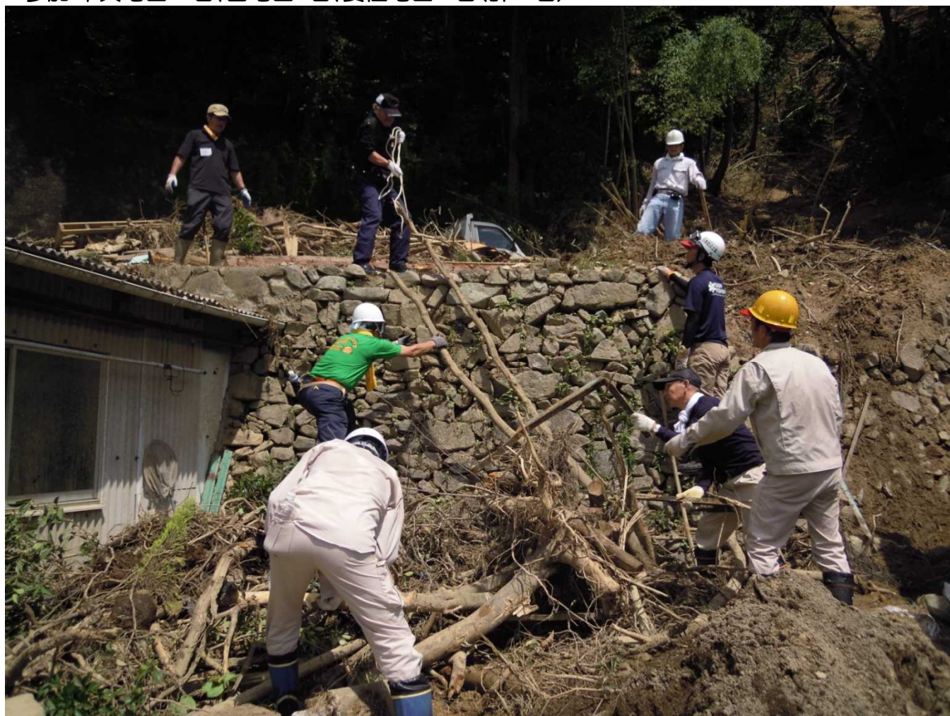
土石流によって大量の瓦礫が流されてきた。それらを防災士のチームワークで懸命に取り除く(安佐北区)
