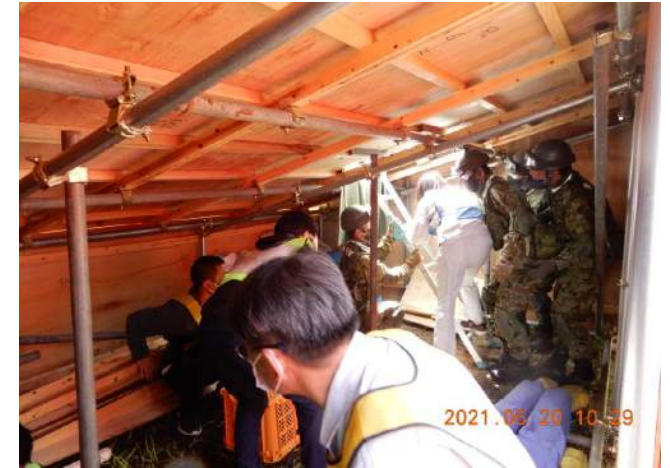
倒壊家屋内の様子
