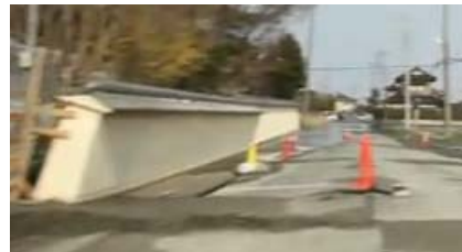
■塀やマンホールの隆起
