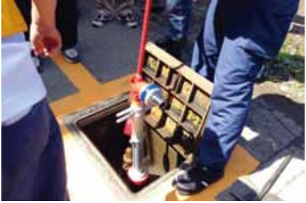
消火栓にスタンドパイプを直結
