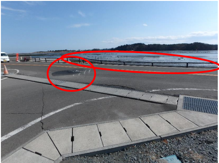
液状化で浮いたマンホール（仮復旧）と落下したガードレール
