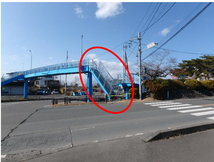
落下した歩道
