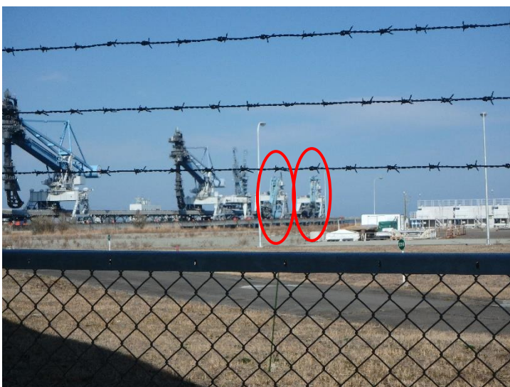
新地発電所（東京へ送電している関連施設）荷揚げ用アームが折れている
