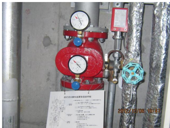
消防用設備の確認と使用訓練
