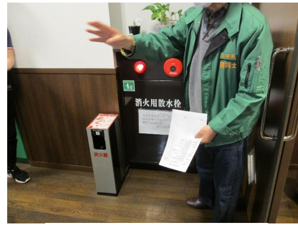
消防用設備の確認と使用訓練
