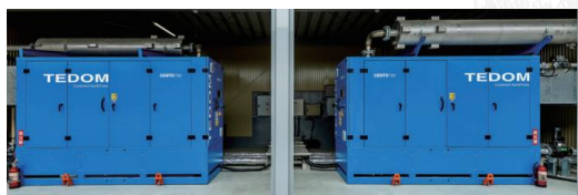
ガスエンジン発電機
